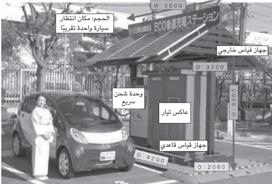
شكل ١٢-١٠: محطة شحن سيارات كهربائية تعمل بالطاقة الشمسية في كيوتو: محطة الشحن، التي قدمتها شركة نيسين إلكتريك المحدودة، مزودة بحزمة بطاريات وعاكس تيار ووحدة شحن سريع. الصورة معروضة بإذن من جامعة كيوتو.
